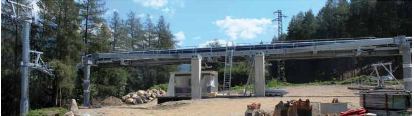
Die einseitige Mittelstation im Talboden mit der Weichenschiene für die Kabinenbahn
